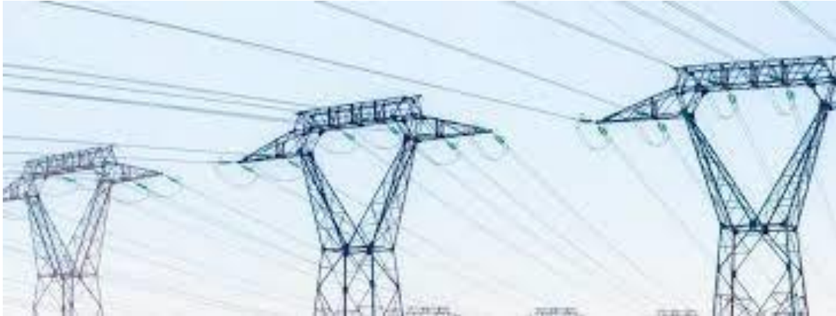
Figure I. 4 : Réseau HTA aérienne.
