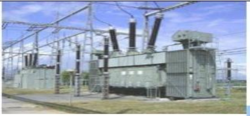
Figure I.12: transformateur de puissance.
