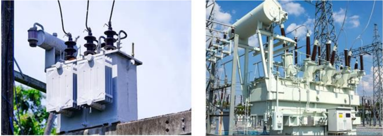
Figure 1.4: Les postes de transformation.
