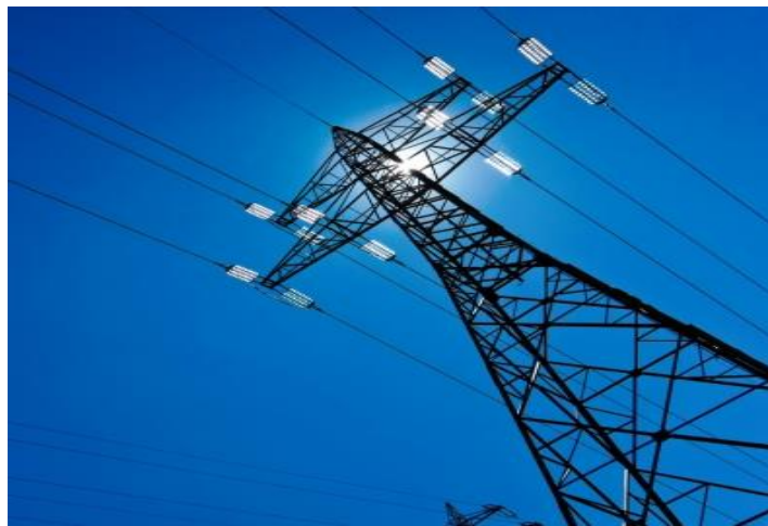
Figure 1.3: Les lignes électriques.
