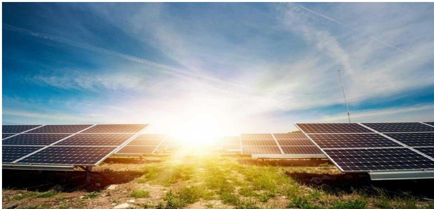
Figure I.3 : Des panneaux photovoltaïques
