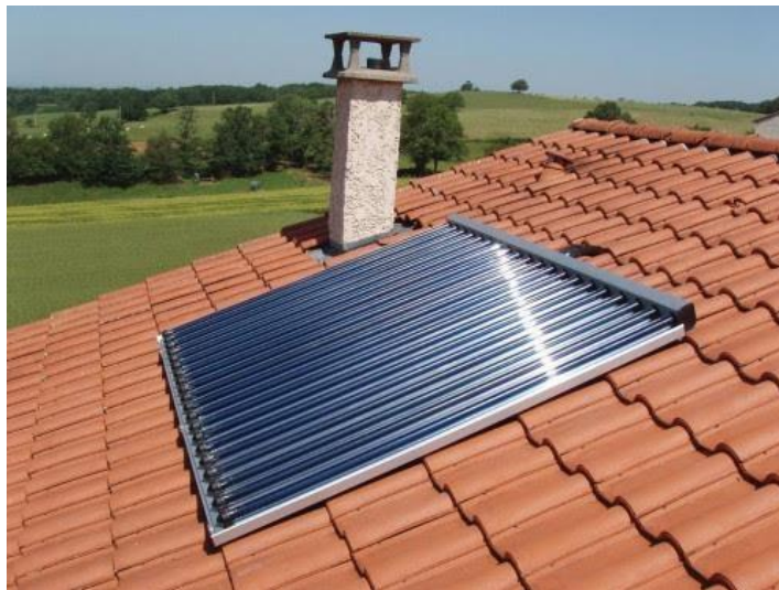
Figure 1.19 Panneaux solaire thermique [47].
