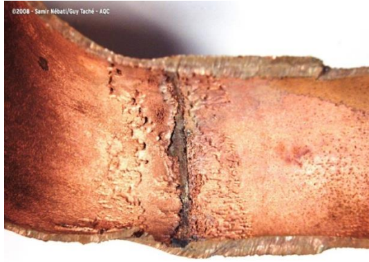
Figure I.8 : Corrosion interne d'un tube de cuivre [15]
