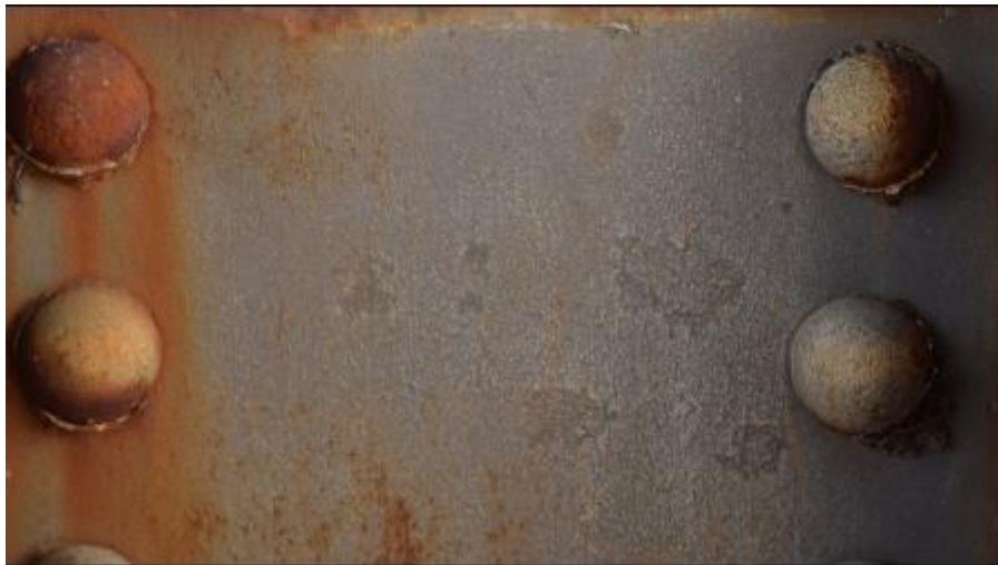
Figure I.9 : Corrosion externe dans un aluminium [16]
