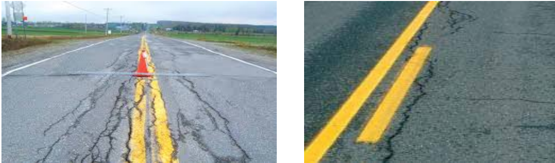
Figure 2.5 Fissure en piste de roues
