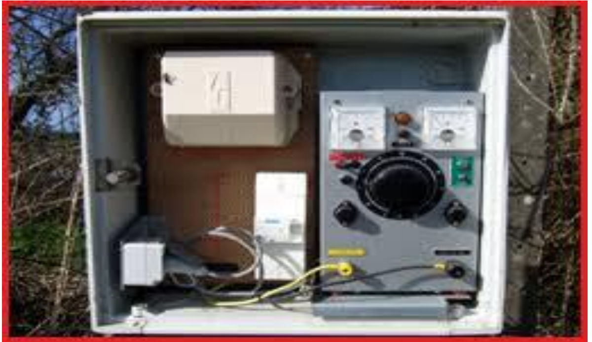
FIGURE 18 : Mini Poste Redresseur
