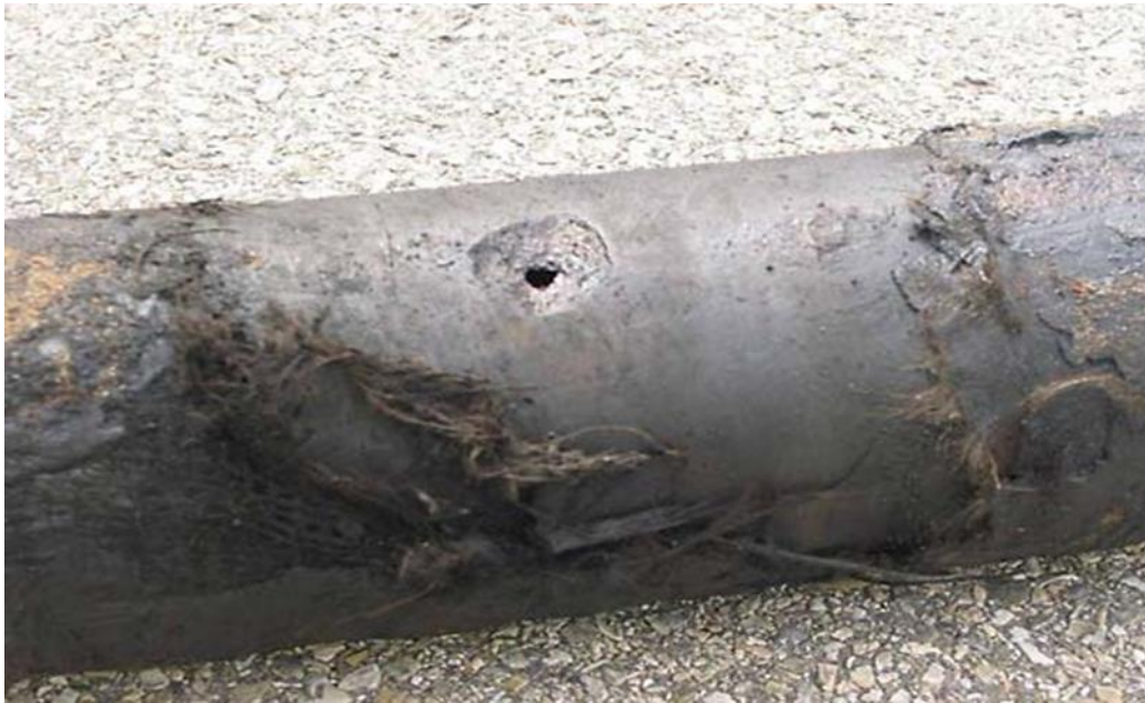
FIGURE 11 : la Corrosion dans les canalisations acier
