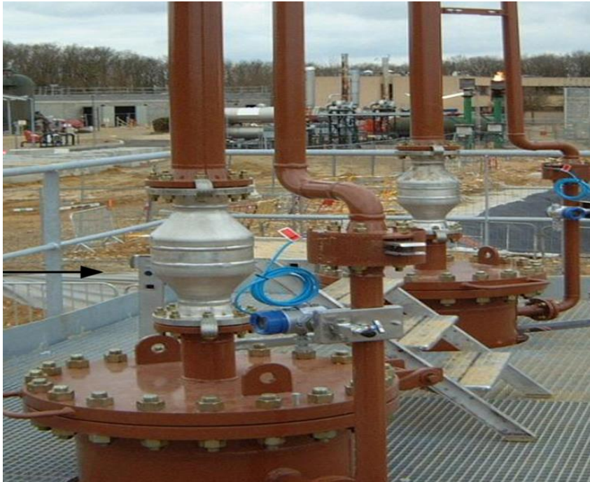
FIGURE 05 : Canalisation en acier
