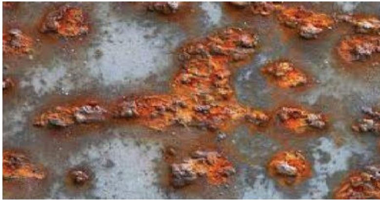
Figure I.3 : corrosion par piqure [38].
